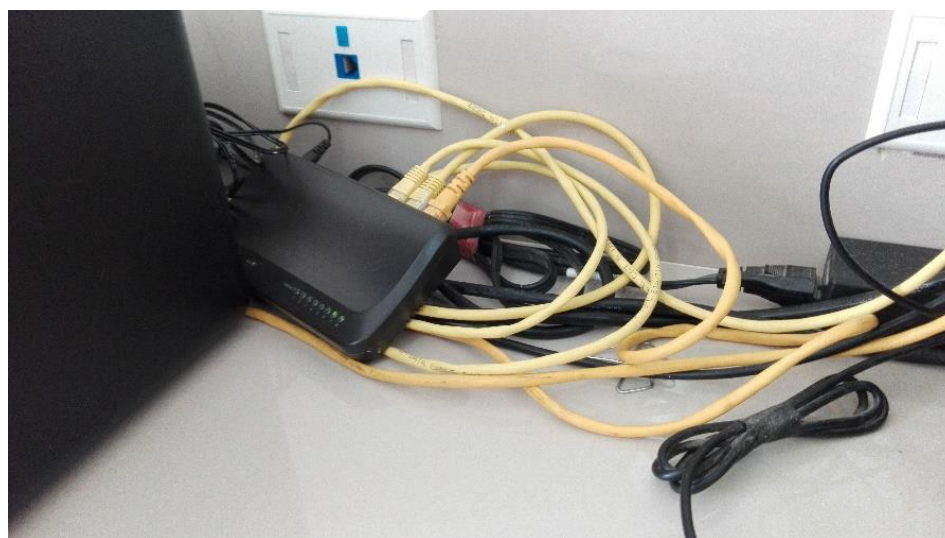
Figura 13. Conmutador en Uso Fuera de Área de Control
