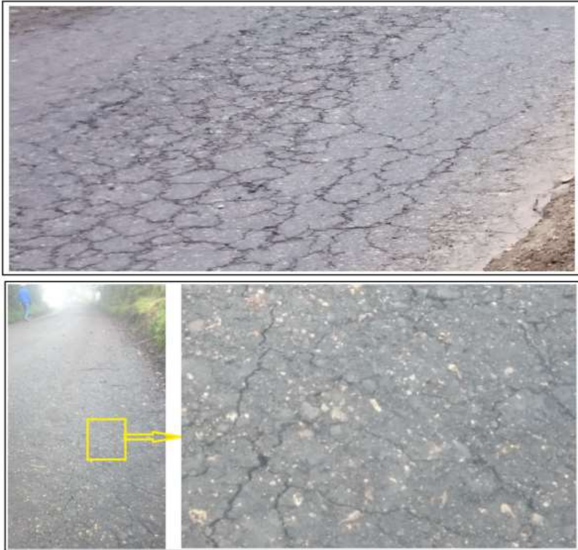
Figura 19. Aspecto de las fisuras en bloque y piel de cocodrilo.
