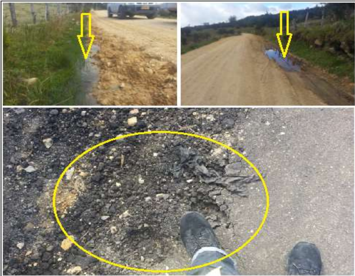
Figura 22. Deficiencias del soporte en las orillas.
