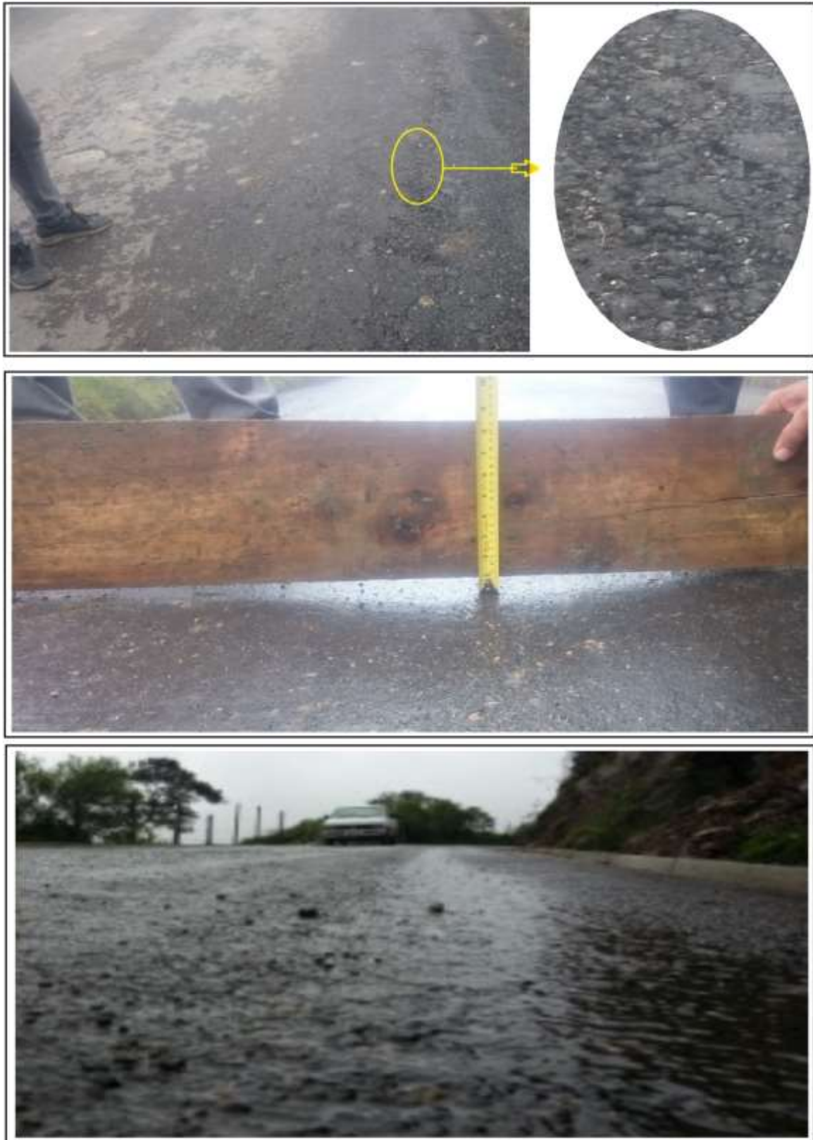
Figura 20. Aspecto de otras fallas asociadas a las deficiencias de construcción.
