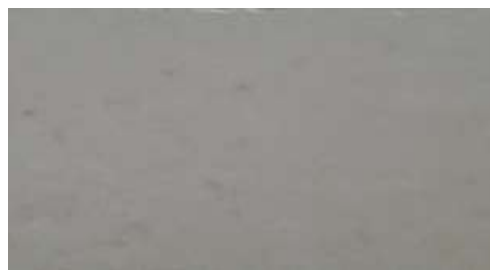
Imagen 30. Defecto por protectora lisa
