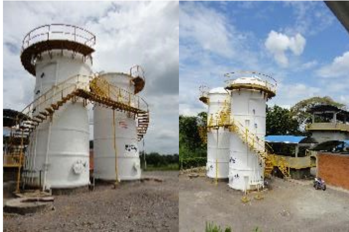
Ilustración 155. Segunda fase tratamiento de lixiviados-Reactores Anaerobios
