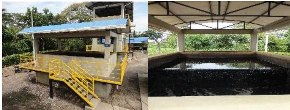
Ilustración 133. Tratamiento preliminar planta de lixiviados Fuente: el autor
