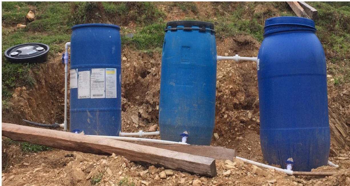
Figura 13. Filtros Purificadores de Agua Implementados por el Proyecto REP. Esta imagen corresponde a filtros lentos implementados en la vereda el Rosal, corregimiento de la Gallera.
