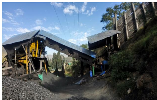
Fotografía No 2 Soporte de mantenimiento de sistema de control particulado trituradora
