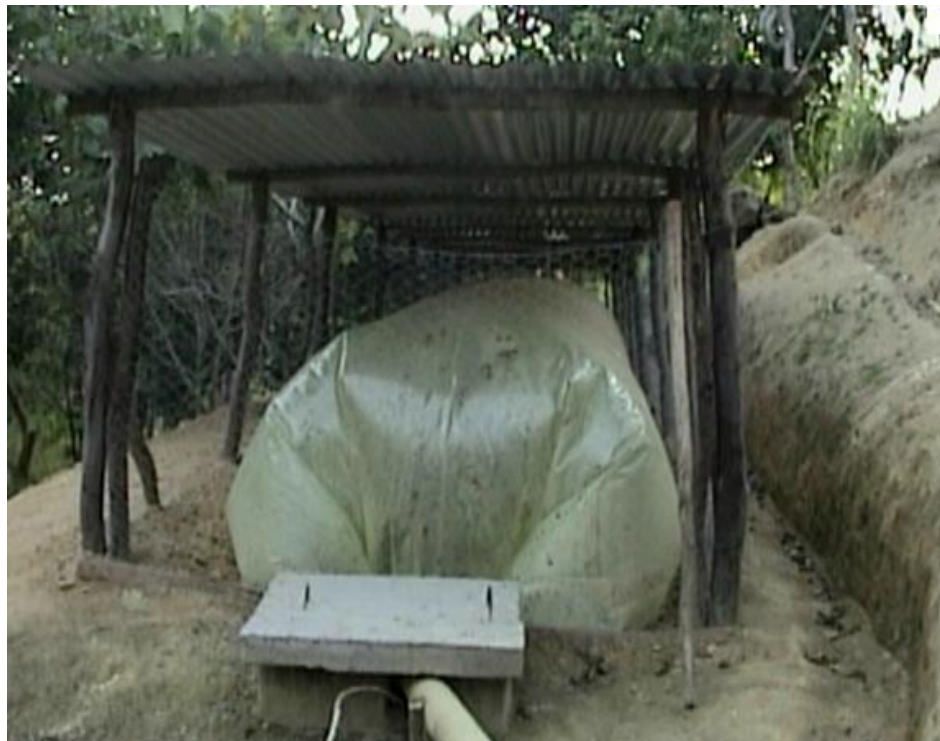
Figura No. 2 Biodigestor Tubular de Flujo Continuo
