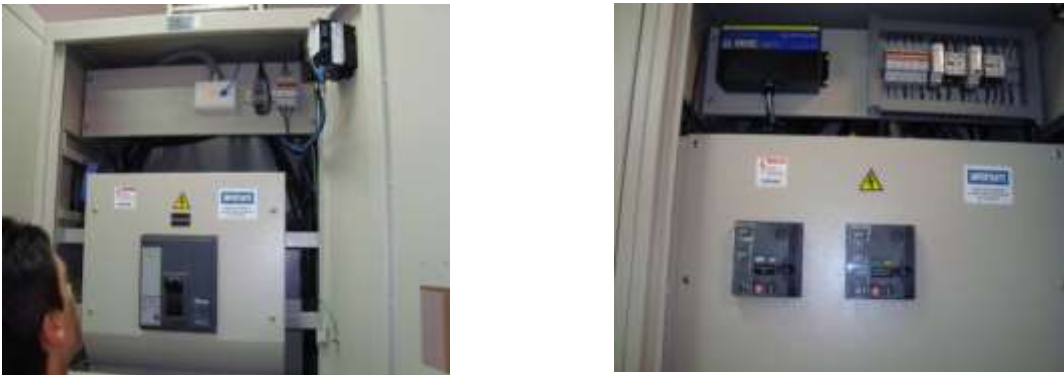
Figura 49. Controles subestación eléctrica
