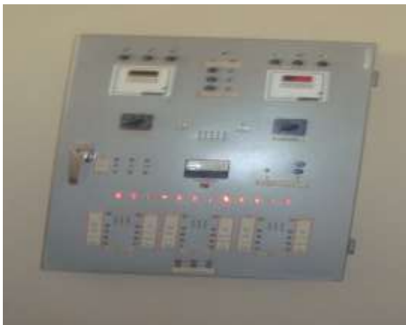
Figura 25. Tablero de control eléctrico área de servidores
