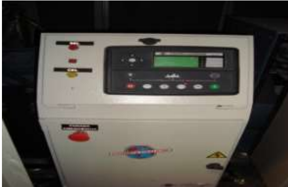
Figura 58. Consola de administración subestación eléctrica UMI
