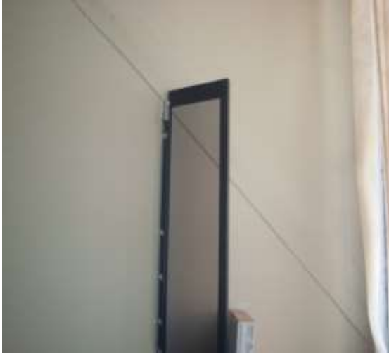
Figura 27. Desfogue aire acondicionado área de servidores
