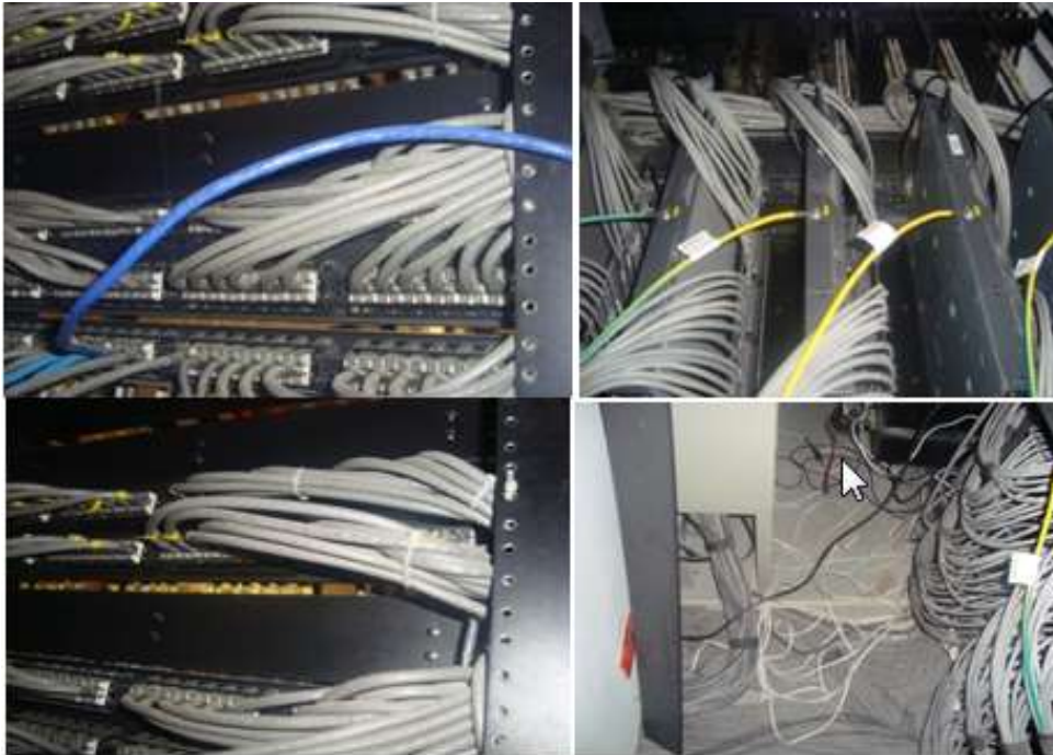
Figura 44. Distribución de cables en centro de cableado UMI
