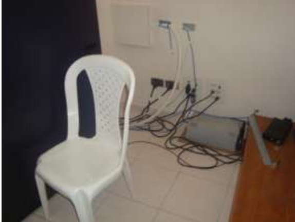
Figura 24. Evidencia sistema eléctrico área de servidores
