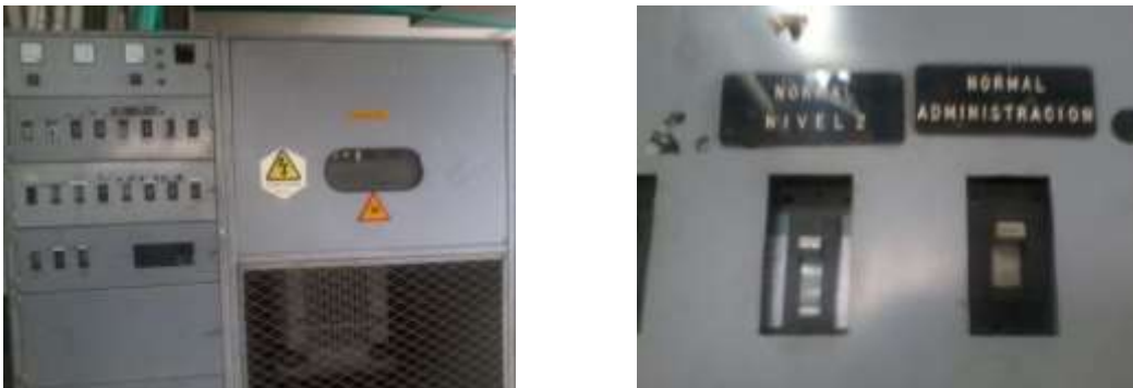
Figura 53. Circuitos estación eléctrica edificio antiguo
