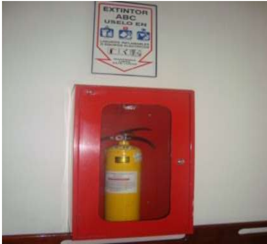
Figura 28. Extintor área de servidores
