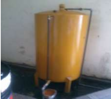
Figura 59. Tanque de combustible subestación eléctrica edificio antiguo
