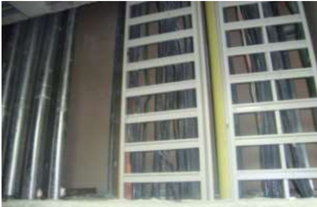
Figura 45. Soporte red de cableado UMI
