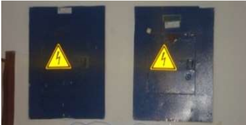
Figura 35. Tableros de circuitos área asistencial
