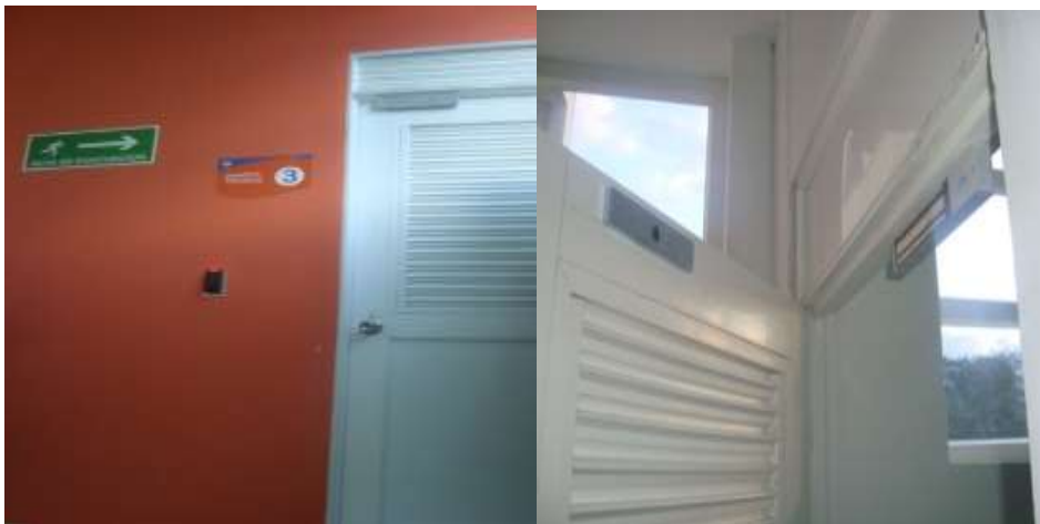
Figura 39. Control Biométrico cuarto técnico
