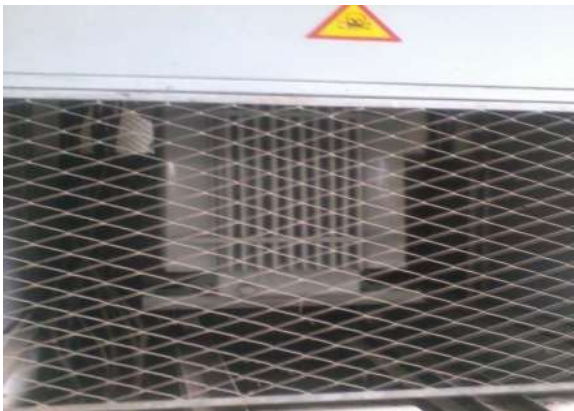
Figura 55. Transformador subestación eléctrica edificio antiguo
