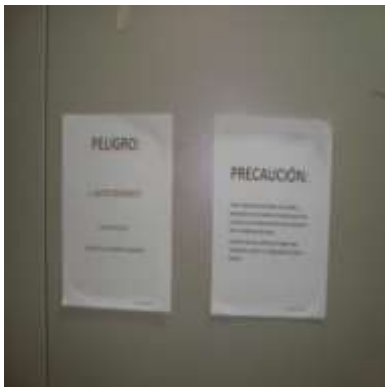
Figura 48. Marquillado de Armarios
