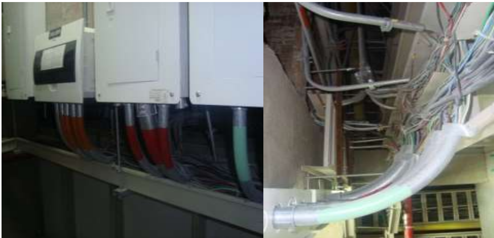
Figura 42. Distribución cables eléctricos área de UPS UMI
