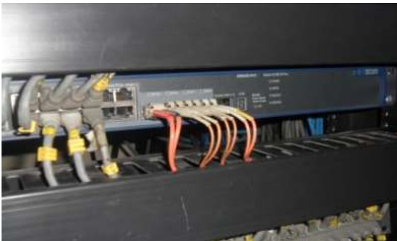
Figura 31. Distribución Backbones Fibra Óptica
