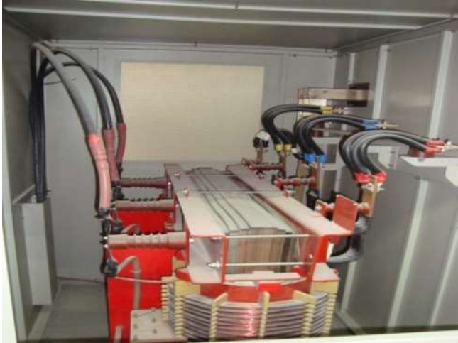
Figura 56. Transformador subestación eléctrica UMI
