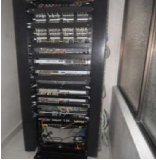
Figura 29. Switches Centro de Cableado
