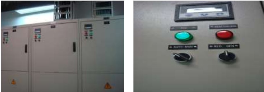
Figura 50. Transferencias Subestación Eléctrica
