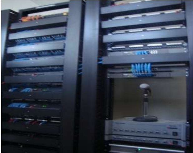
Figura 43. Armarios de distribución centro de cableado UMI
