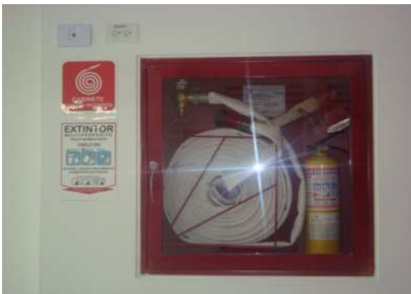
Figura 46. Elementos de seguridad contra incendios UMI
