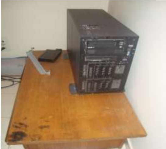
Figura 23. Mesa de madera en área de servidores
