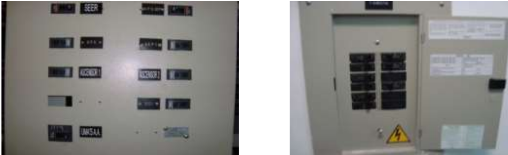
Figura 52. Identificación circuitos subestación eléctrica UMI
