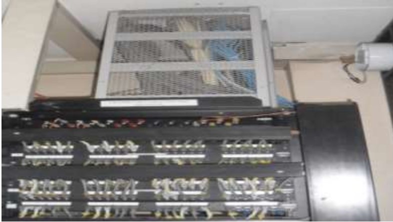
Figura 30. Distribución de cableado
