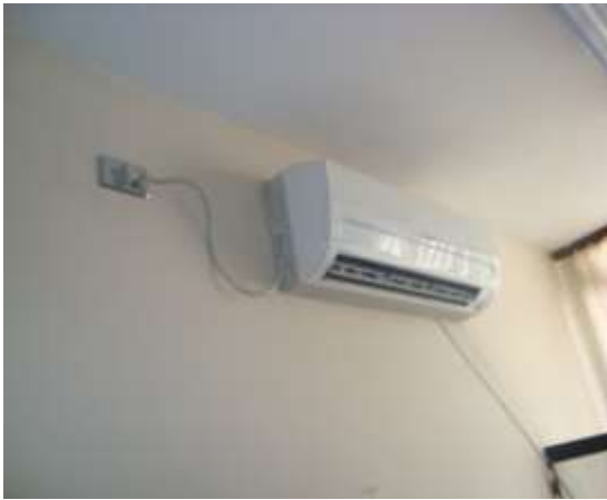
Figura 26. Aire acondicionado área servidores
