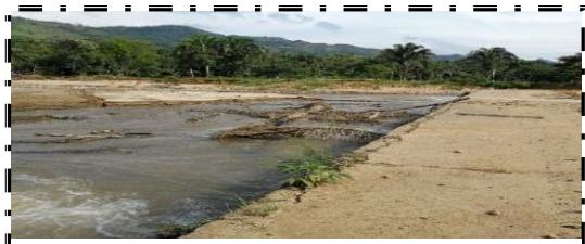
Figura 1 Infraestructura en Riesgo
