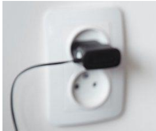
Figura 5. Conexión dispositivo tomacorriente, Autor: Autoría propia.
