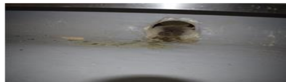
Inadecuadas condiciones de infraestructura y material en desuso en equipos.
