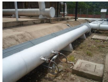
Figura 19. Caudalímetro y línea de 20" (Planta Modular)
