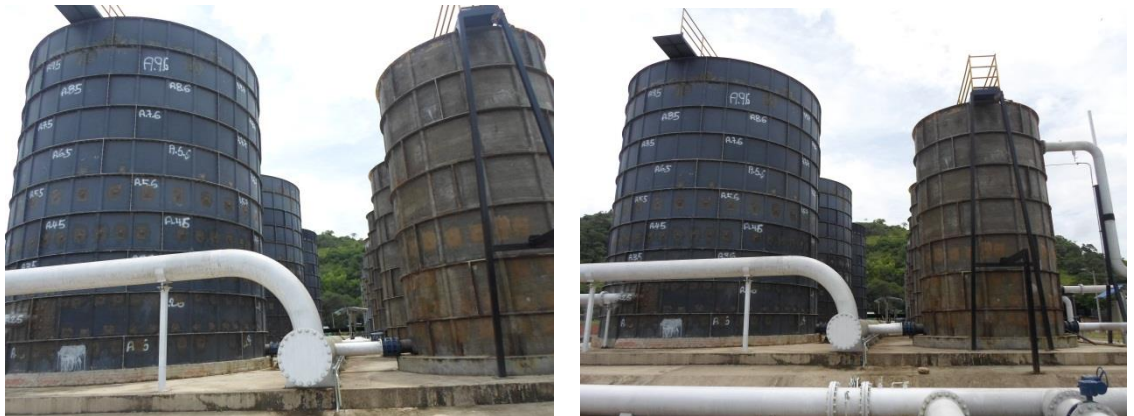
Figuras 22 y 23. Filtros Gigantes (Planta Modular)
