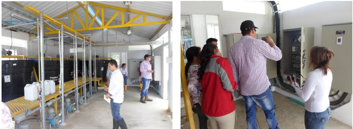
Figuras 20 y 21. Sala de dosificación y Bodega (Planta Modular)
