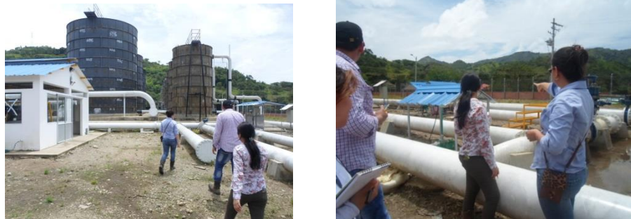
Figuras 17 y 18. Líneas de 16" y 18" receptoras del Bocatoma (Planta Modular)
