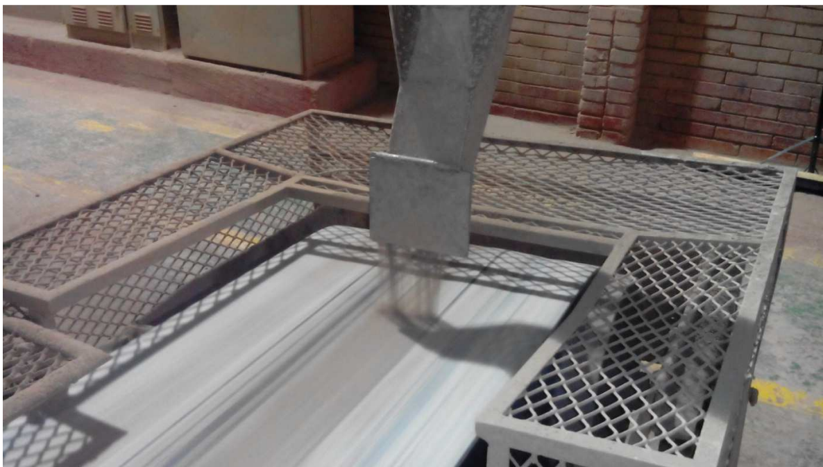
Imagen 56. Ducto caída polvo retenido
