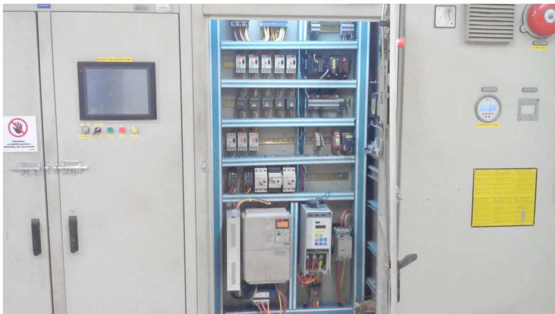
Imagen 30. Montaje final cabina control abatidores y dispersor
