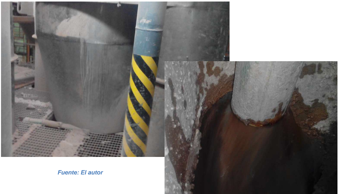
Imagen 55. Ducto adaptado para toma de caudal agua recuperada de abatidores
