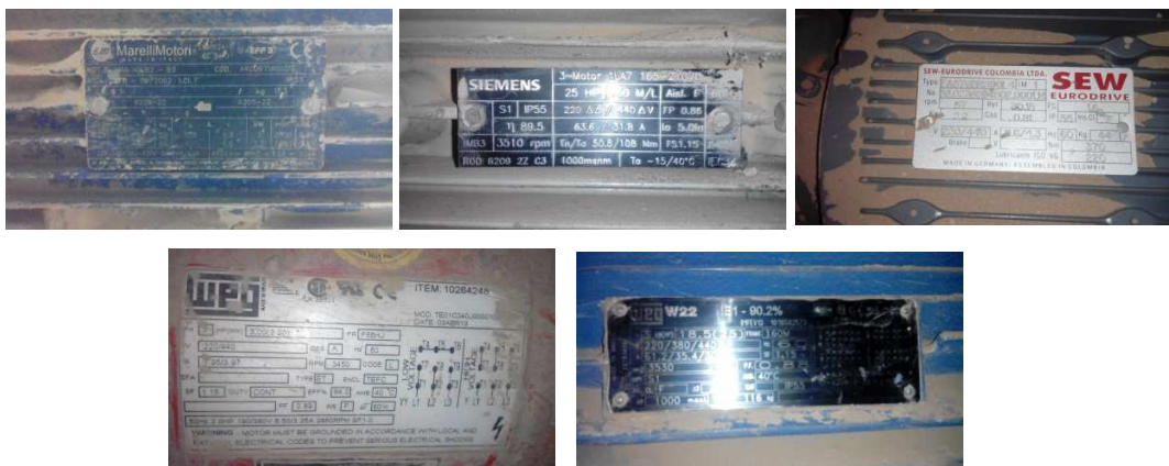
Imagen 5. Placas con especificaciones motores tanque abatidores y dispensor
