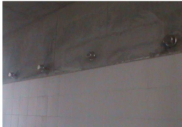
Imagen 8. Duchas Occidente Primer Piso Nuevo Patio 5
