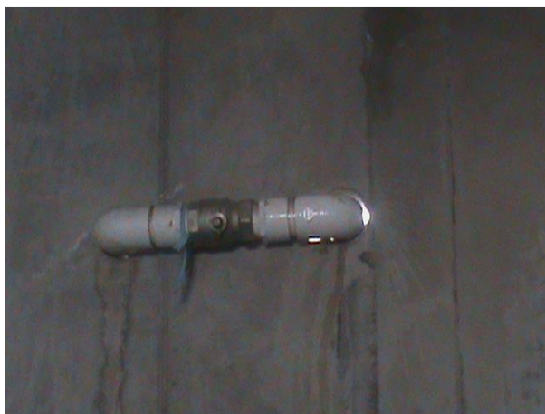
Imagen 13. Llave de Agua Tercer Piso Nuevo Patio 5.
