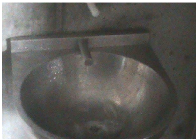
Imagen 14. Avería Lavamanos Nuevo Patio 5
