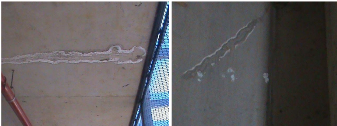
Imagen 11. Humedad en loza y pared Primer Piso Del Nuevo Patio 5
