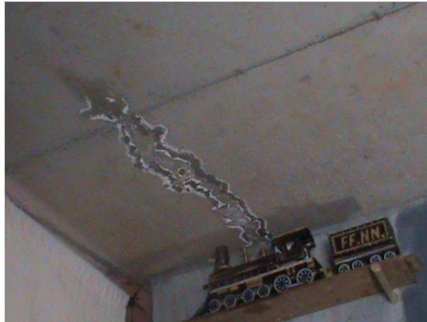
Imagen 10. Humedad en loza Tercer Piso Nuevo Patio 5
