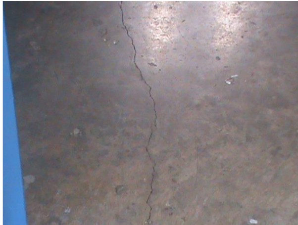
Imagen 12. Fisura en Loza Primer Piso Nuevo Patio 5
