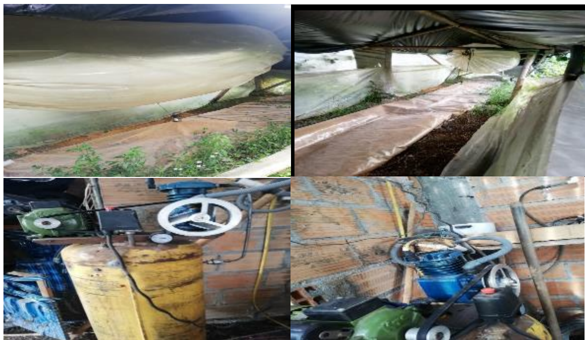
Ilustración 17 Rojas, L. (2020) Biodigestor generador de gas metano. {Fotografía}
