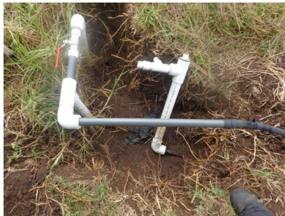
Imagen 11. Sistema de riego averiado granja IETA Chivatá
