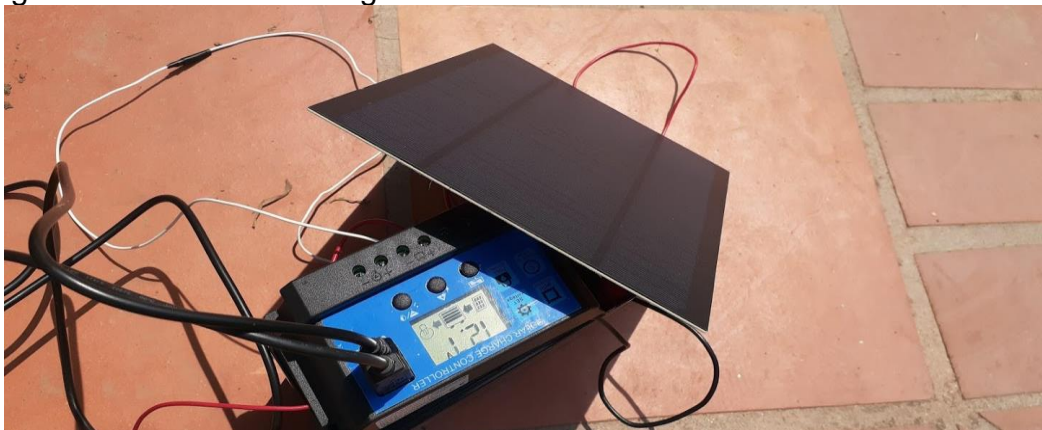
Imagen 25. Sistema de energía solar en el exterior.
