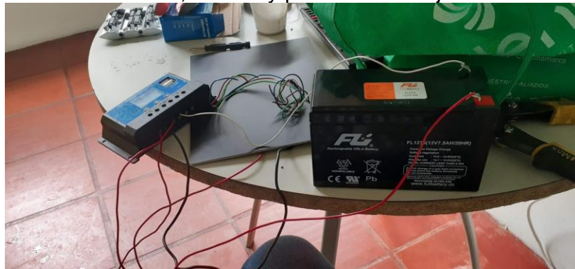
Imagen 24. Foto de Controlador, batería y panel boca abajo.
