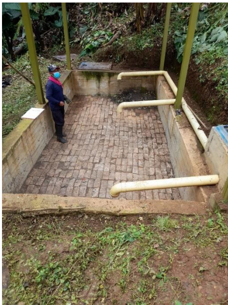
Lecho de secado de lodos de la PTAR vereda Media Naranja
