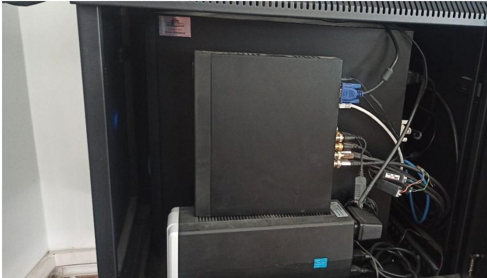
Figura 6: [COM] Rack de comunicaciones
