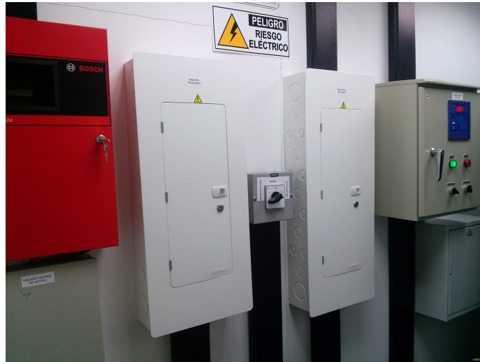
Figura: 18 Tableros eléctricos
