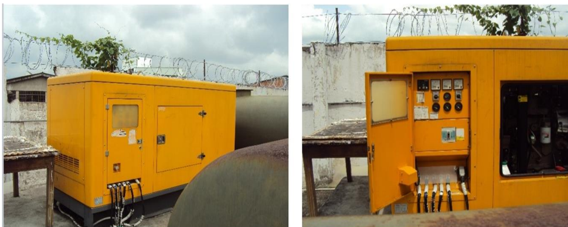
Figura 6. Planta eléctrica comando de policía Caquetá
