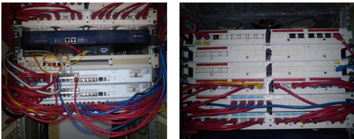
Figura 4. Rack principal de red comando de policía Florencia
