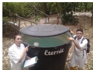
Imagen 9 Identificación del Agua tratada en tanque de 2000L
