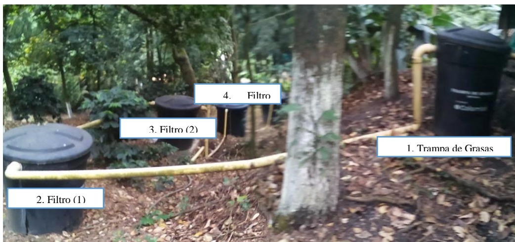
Imagen 4. Identificación del Sistema conformado por una trampa de grasas, 4 Filtros (Gravilla, Arena, Carbón Activado y Geo Textil)
