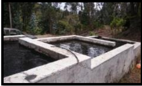
Figura 6. Tanque de sedimentación. Fuente: La Autora, 2016.
