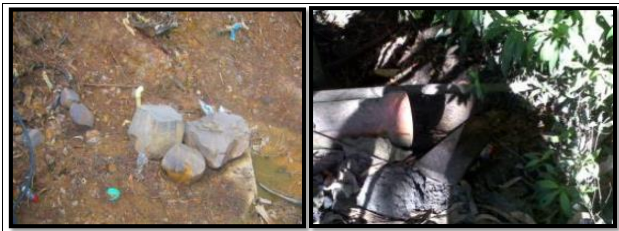
Figura 14. Tubería de aguas residuales. Fuente: La Autora, 2016
