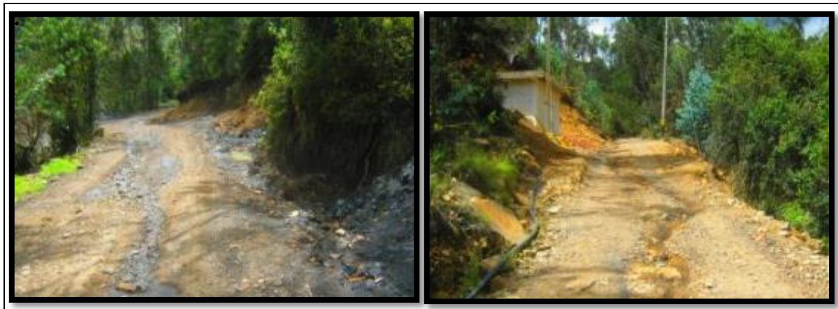
Figura 11. Inadecuado manejo de aguas en vías de acceso Fuente: La Autora, 2016
