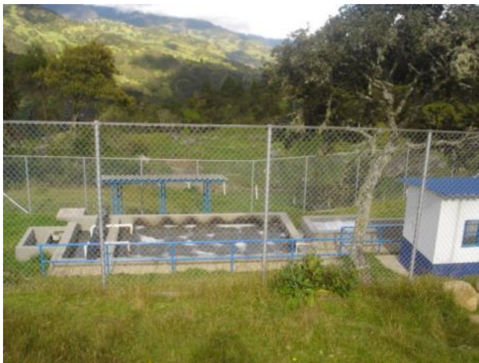
Planta de tratamiento Aguas Residuales – Vereda Auras Foto: Autora
